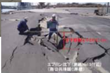
エプロンの舗装部の陥没(鹿島 港)南公共ふ頭地区岸壁 - 7.5m
