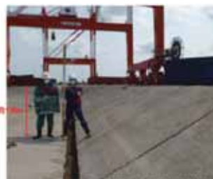
エプロン沈下(常陸那珂港区)北 ふ頭地区岸壁 - 14m
