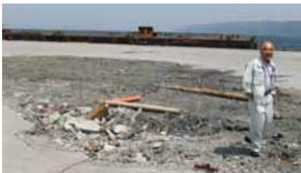
津波によるコンクリート舗装(宮古港岸壁エプロン)の被害状況を調査する赤間辰一郎調査役
