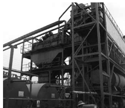
▲エポキシアスファルト混合物製造プラント
