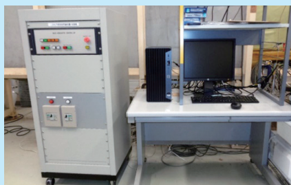
新制御盤とパソコン
