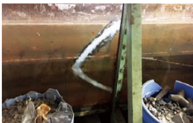
写真② 実験水槽ガラス面のひび割れ
