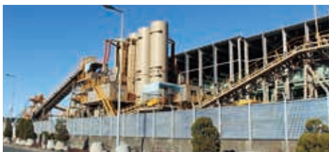
泥水圧シールド工法の泥水処理施設
