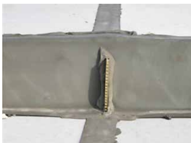
水抜きパイプ
