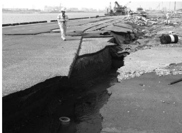
▲被災を受けた岸壁背後（石巻港）
