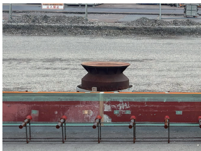
電力や空調、給油等を航空機へ供給するためのピット。 スポット内に多く設置されている
