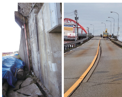
伏木港大橋の被災状況：（左）擁壁の傾斜（右）擁壁の傾斜による舗装の沈下、段差、亀裂 画像提供：国土交通省 北陸地方整備局 伏木富山港湾事務所
