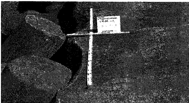
写真-7 上部工の小規模な欠損（ひび割れあり）
