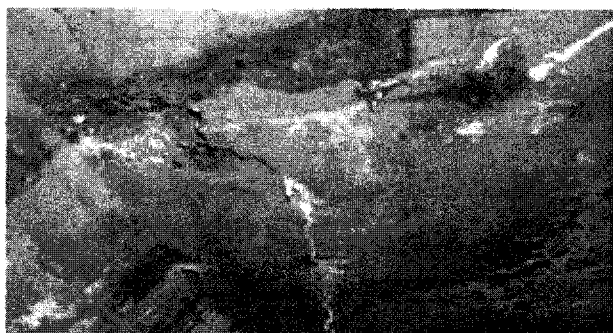
写真-3 スラブの複合的な変状
