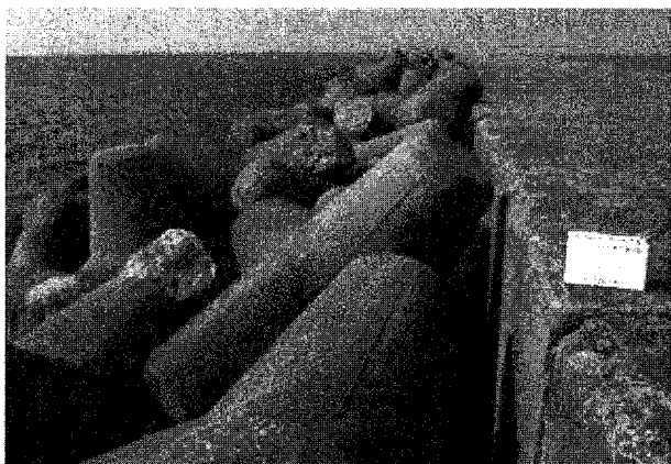
写真-14 消波ブロックの断面減少状況
