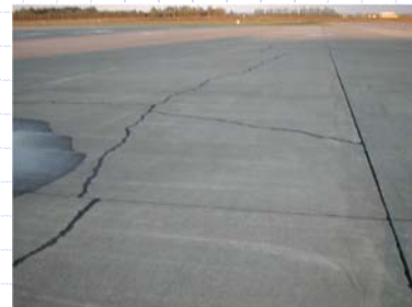
凍上によるひび割れ
