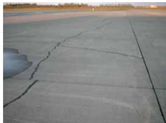
凍上によるひび割れ
