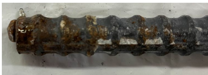
図-3.7 エポキシ樹脂被覆部における腐食の拡大写真
