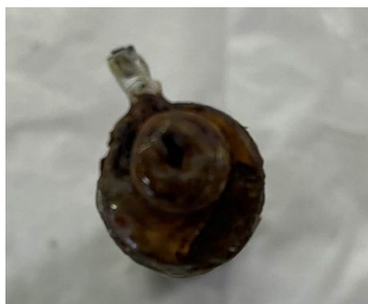
図-3.8 鉄筋上端部の腐食写真
