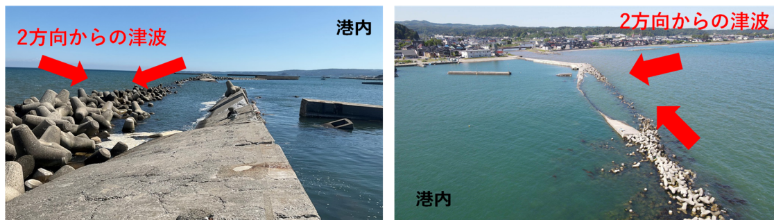
図-22 飯田港東防波堤の被災状況
