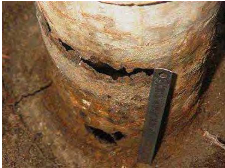
写真－1.1 道路標識柱の腐食事例
