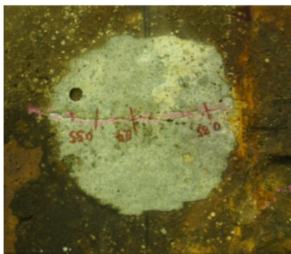
供試体底部ひび割れ状況
