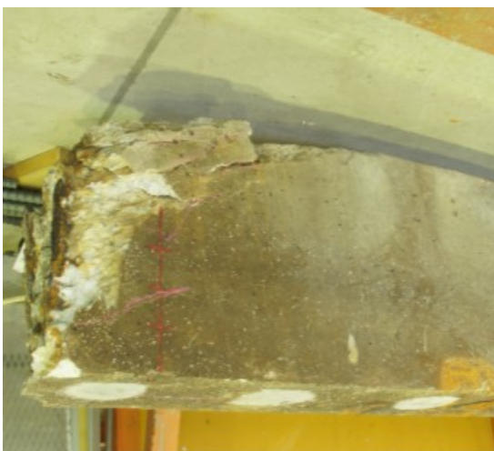
端部劣化状況
