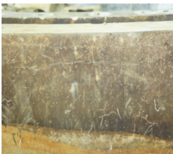
側面ひび割れ状況
