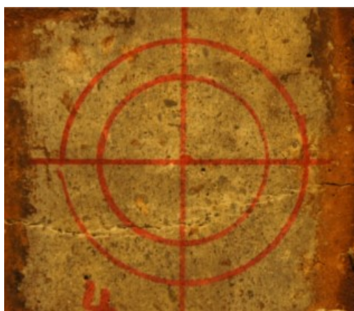
供試体底部ひび割れ状況
