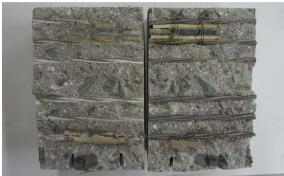
図 6-21 測定端子と周囲の PC 鋼線腐食状況
