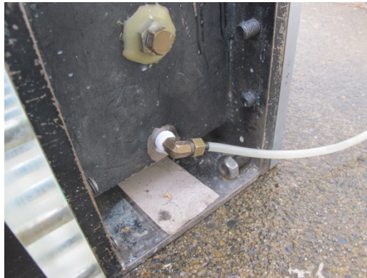
図-3.3 排水パイプ
