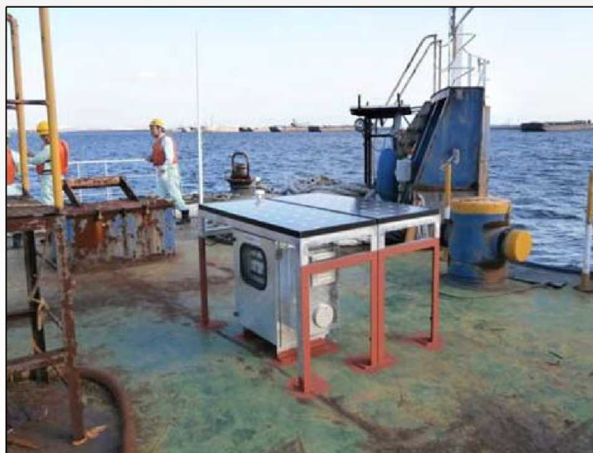
図7 実験船に設置した自立電源式 AIS装置(クーラー付き)
