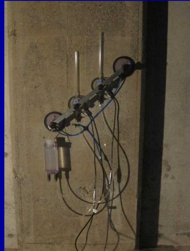
貯水タンク 壁面 ペーストが溶脱(細骨材残) ※水流なしのため表面の包絡面はフラット
