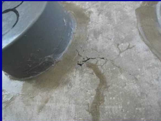
離れた位置から水漏れ
