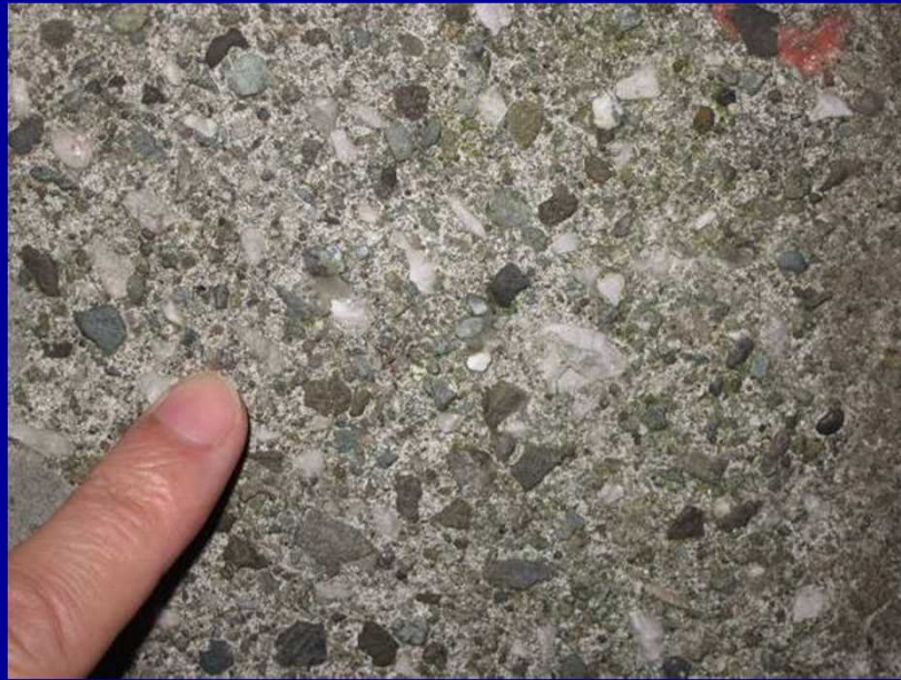
経年30年 屋外壁 モルタル溶脱(粗骨材露出) ※表面の包絡面は凸凹
