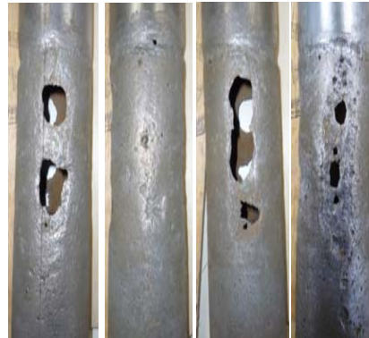
写真-1 鋼管の腐食状況 (HK100)
