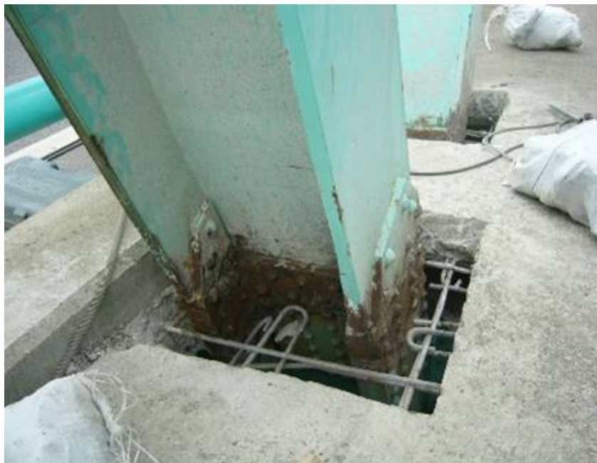
写真-2.2 実トラス部材の腐食状況
