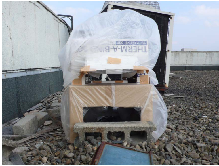
図 6.8 屋上に設置した無線センサ（ノード番号 10710）
