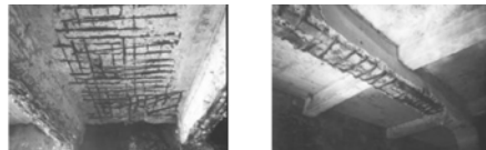
上部工床版下面(左)と梁下面(右)の劣化状況
