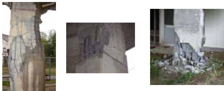
図 - 1.3 損傷した RC 部材の例(土木学会(第1次)・地盤工学会合同調査団 調査速報(Ver. 1.0, 2005年1月11日)より)
