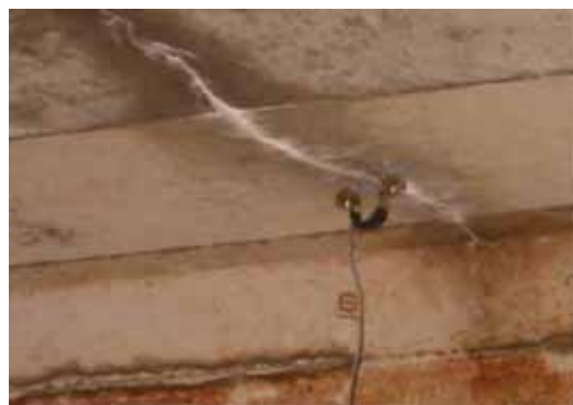
図 - 3.1 計測対象ひび割れ
