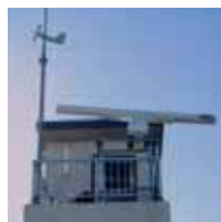
レーダ 設置状況
