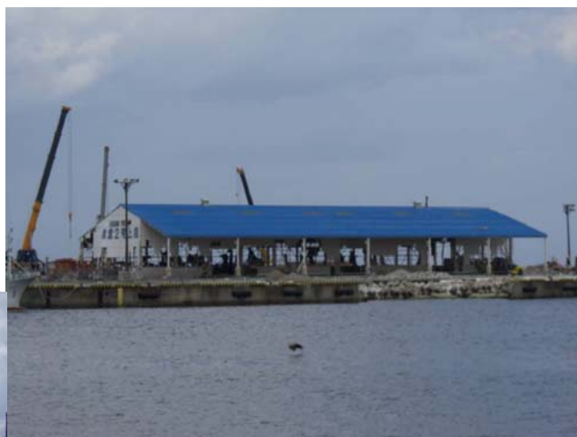
上屋：津波により壁が流出
