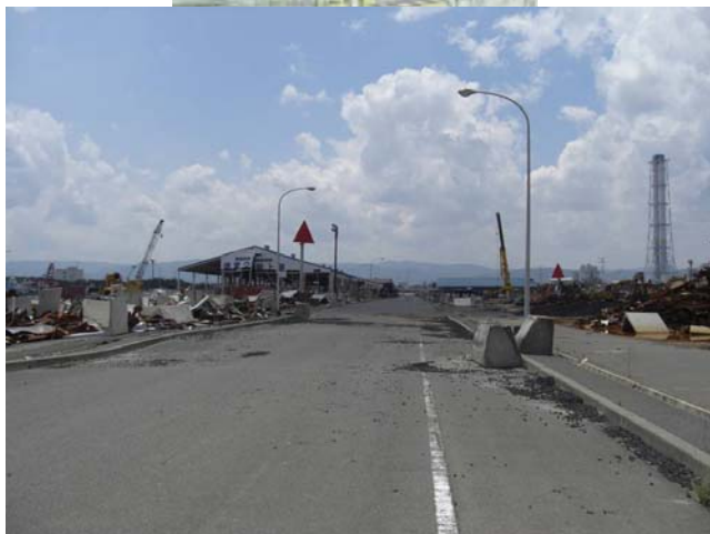
ふ頭内道路：うねり、陥没多数
