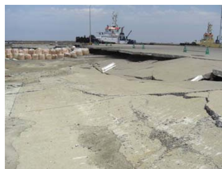
岸壁背後エプロン陥没
