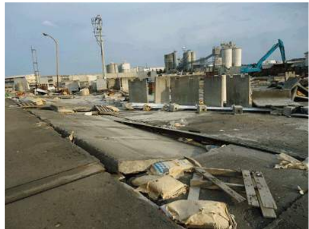
中埠頭(前面棧橋の渡版)被災状況
