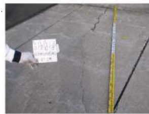
写真 1a) コンクリートひび割れ
