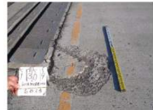
写真 1b) コンクリート損傷
