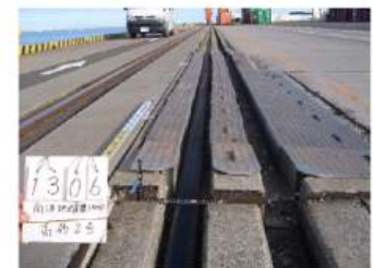
写真 1d) ケーブルダクト部の沈下
