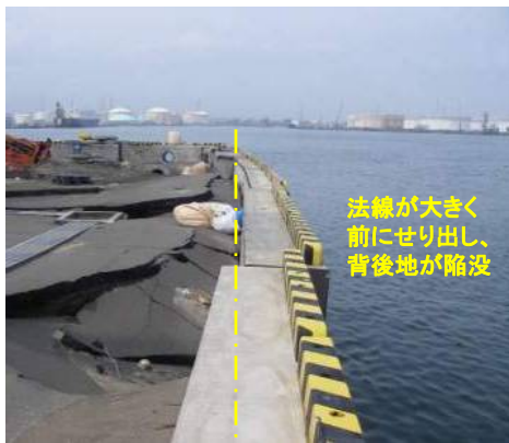
岸壁との隅角部は、護岸のはらみ出しに伴い、裏埋土が海に流出し地下埋設物までも崩壊
