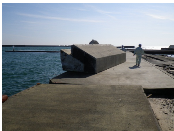
津波で流された上部工（大津漁港）
