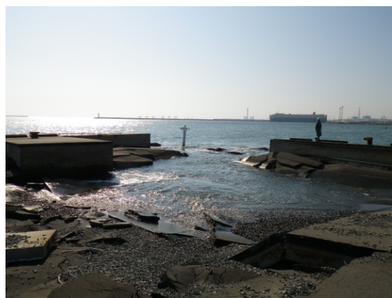
滑動したケーソン岸壁（日立港）
