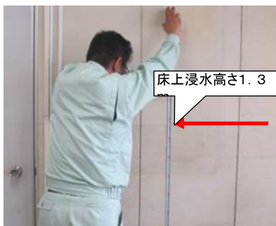
塩釜港湾・空港整備事務所内(1階)津波による浸水高さ
