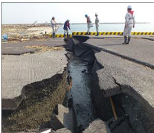
石巻港雲雀野岸壁-12m被災状況
