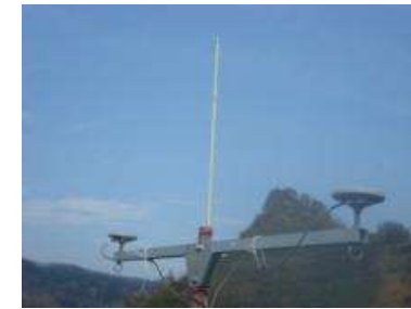
GNSS アンテナ
