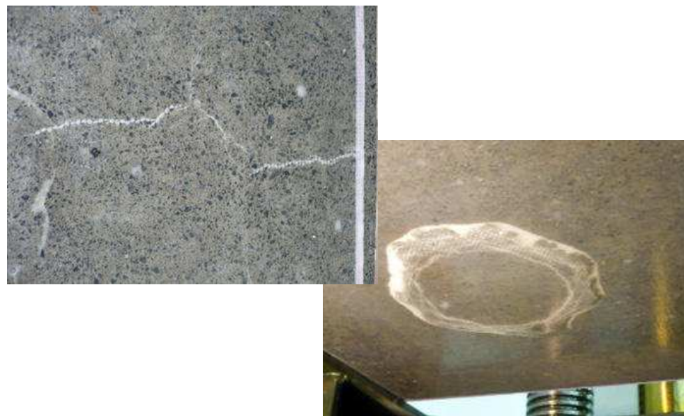
変状の発生状況
