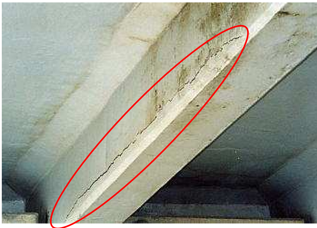
断面修復・表面被覆後のひび割れ
