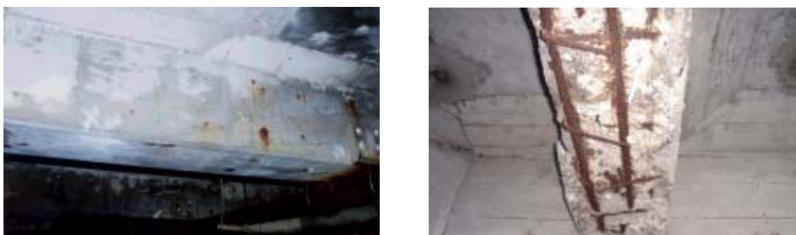
写真 1-1 建設後 20 年経過した栈橋上部工の損傷状況の例
